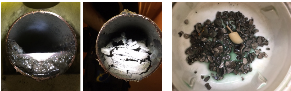
Exempel på rör före sanering, hösten 2017.
